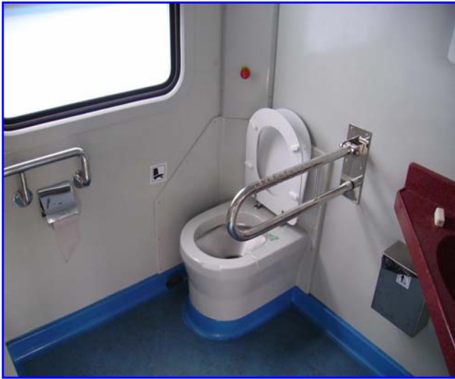
Rys.29 – Widok na toaletę WC przystosowaną do obsługi osób niepełnosprawnych zastosowaną w zmodernizowanych ezt EN57
